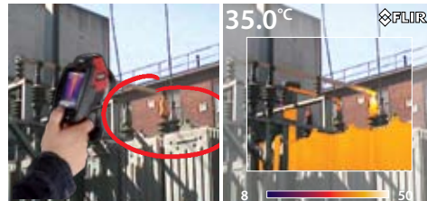
Inspection d'un transformateur au moyen de la fonction Fusion Image dans l'image.
